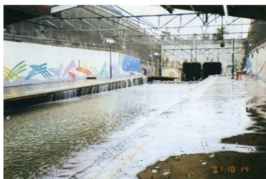
武蔵野線新小平駅で地下水の異常上昇によって発生した隆起災害
